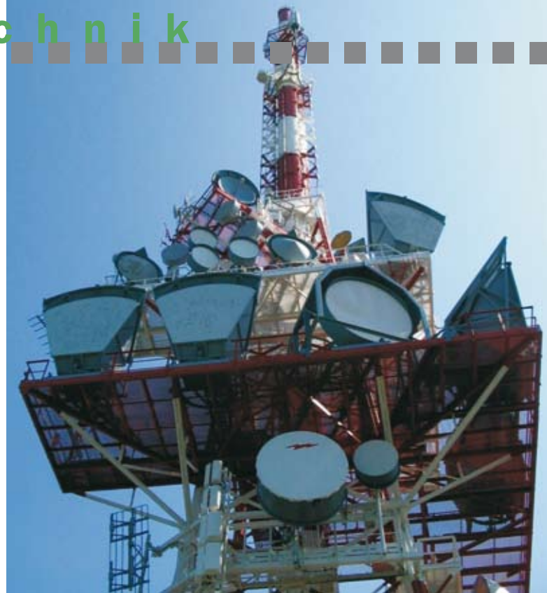
Abb. 2: Die oft große Zahl der auf Funktürmen installierten Antennen macht es notwendig, mittels Messungen Sicherheitsbereiche auf den verschiedenen Plattformen zu bestimmen.
