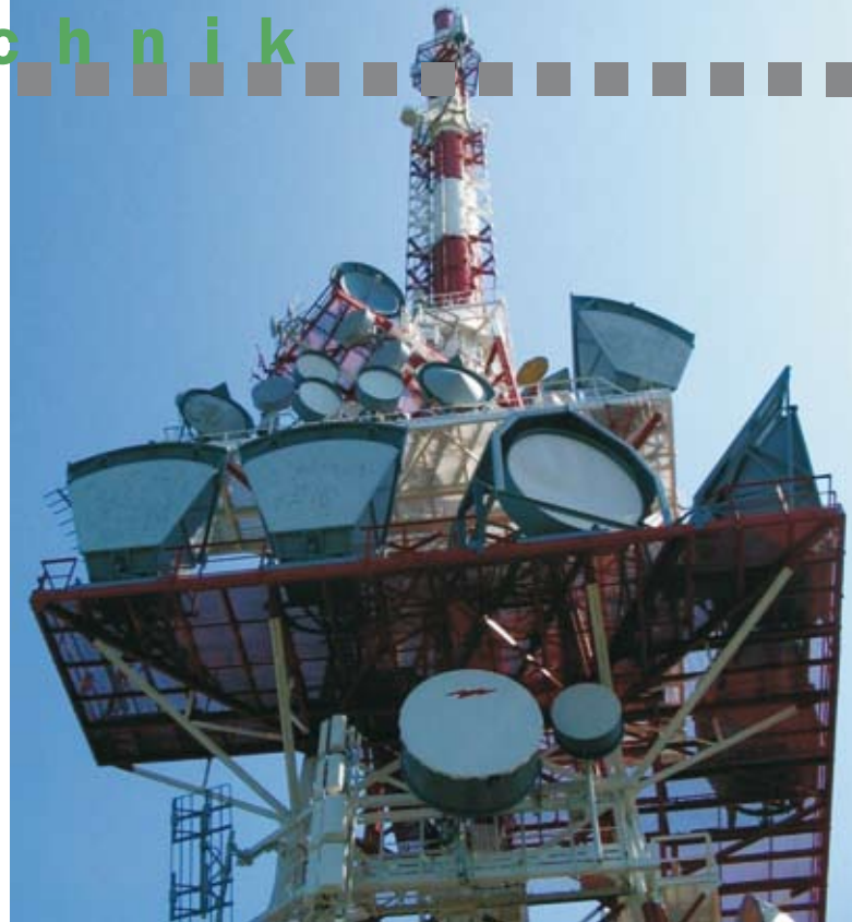
Abb. 2: Die oft große Zahl der auf Funktürmen installierten Antennen macht es notwendig, mittels Messungen Sicherheitsbereiche auf den verschiedenen Plattformen zu bestimmen.
