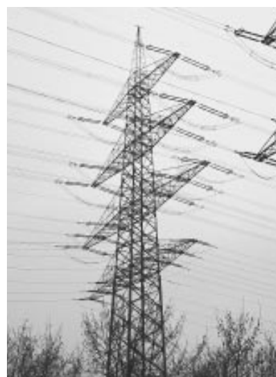
Die NCRP-Studie befaßte sich mit Frequenzbereichen, die elektrischen Geräten und Hochspannungsleitungen entsprechen. (Foto: Wissenschaftsladen Bonn)
